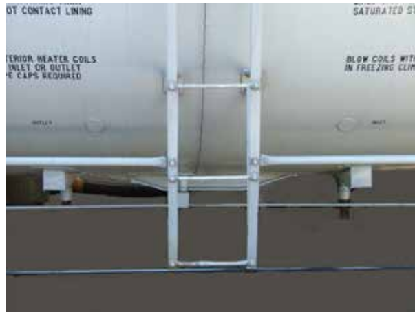
Cette photo illustre l'entrée et la sortie du circuit de chauffage sous un wagon-citerne.
