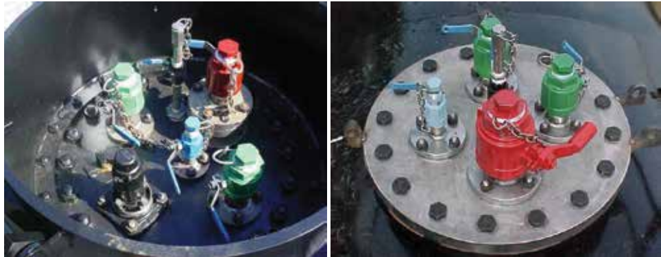
Les photos ci-dessus représentent des raccords de déchargement sur un wagon-citerne ordinaire servant au transport du TDI.
